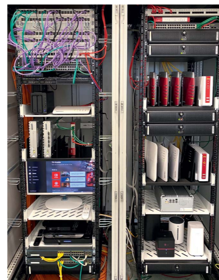
Messen rund um die Uhr: Die automatisierten Testsysteme enthalten die Router der Testanschlüsse, Rechner zur Steuerung und Auswertung sowie eine Firewall.
